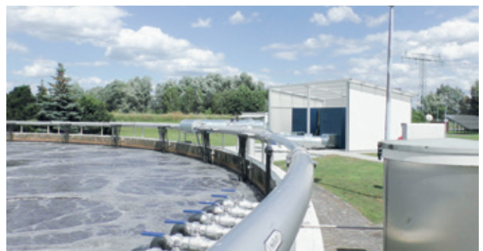
Zwei effiziente Drehkolbenverdichter von AERZEN sorgen für die Druckluftversorgung im Belebungsbecken.
