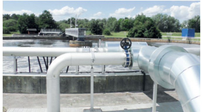
Dank der Außenanstellung der AERZEN-Gebläse kann die verbindende Rohrleitung extrem kurz ausfallen, was die Energieverluste auf ein Minimum reduziert.
