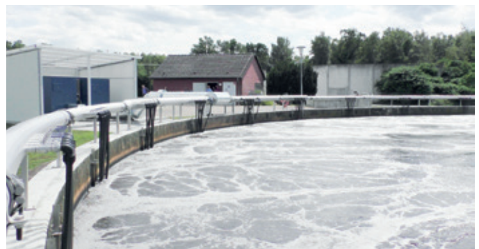
Durch eine Optimierung des Belüftungssystem im Belebungsbecken lässt sich die Effizienz von Kläranlagen deutlich erhöhen.
